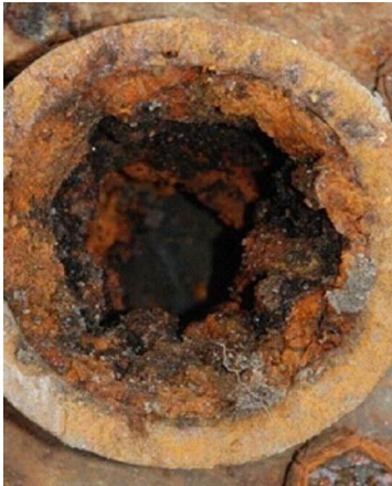
Eksempel igjengrodd rør
